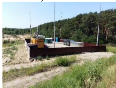
Фото. Когенераційна установка
